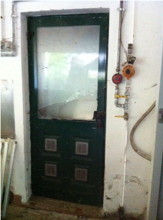
(foto 7): porta danneggiata, retro edificio Spiaggia d'Oro
